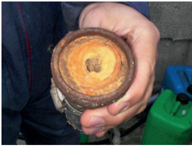
Photo 5 : colmatage d'un tuyau par du fer (Crédit photo : Céline Chevance)
