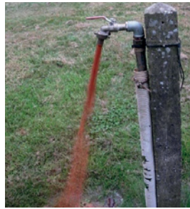
Photo 6 : résultat d'un nettoyage mécanique des canalisations (Flush Pipes) (crédit photo : Céline Chevance)
