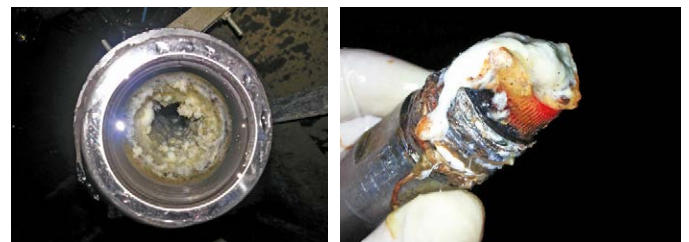
Photos 1-2 : Différents biofilms dans les canalisations d'eau de post-sevrage (Source : Porc.Spective).
