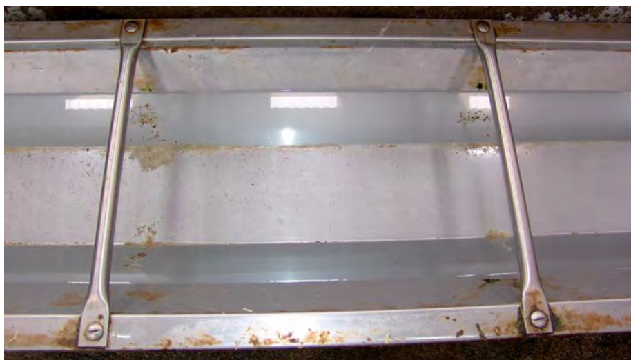
Le débit des abreuvoirs est à vérifier
